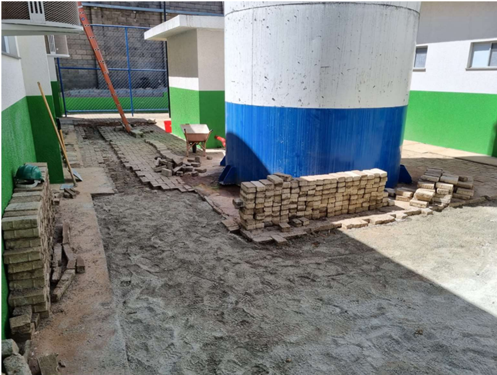
Correção de nível do piso na área externa próximo ao reservatório de água 02
