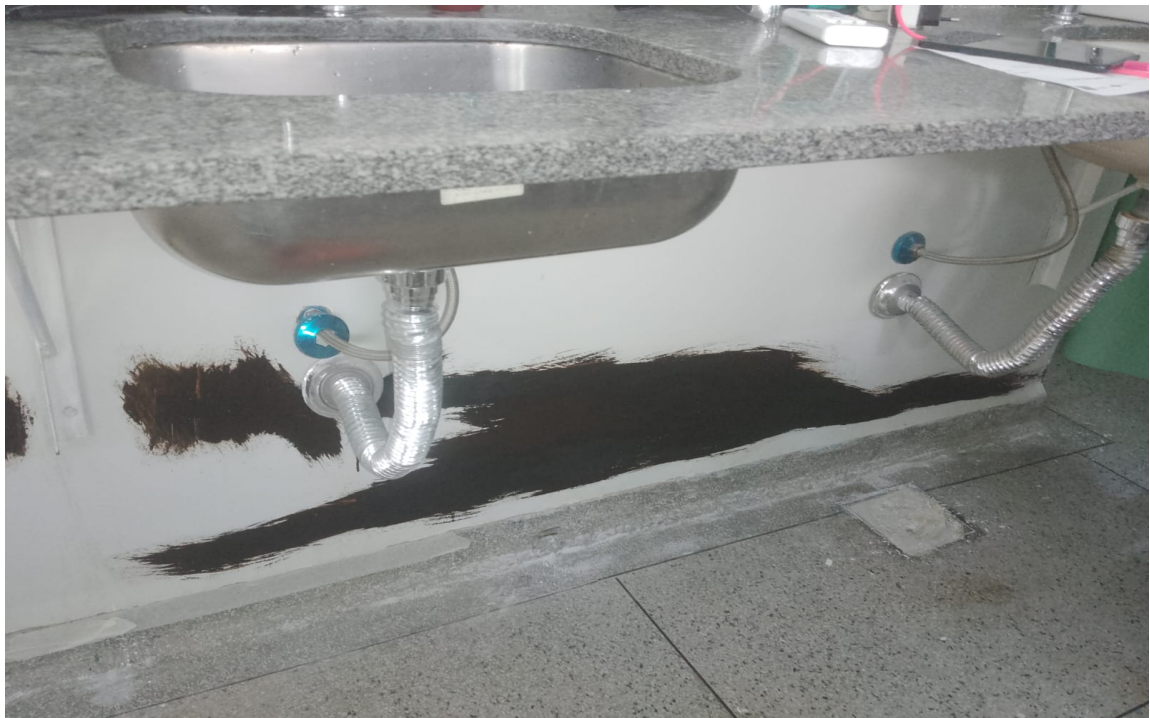
REPARO DE PINTURA ABAIXO DA PIA DO POSTO DE ENFERMAGEM NA UTI
