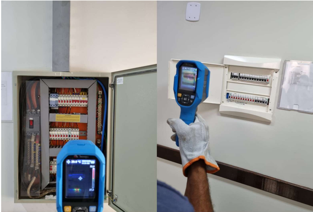
Termografia de quadros elétricos
