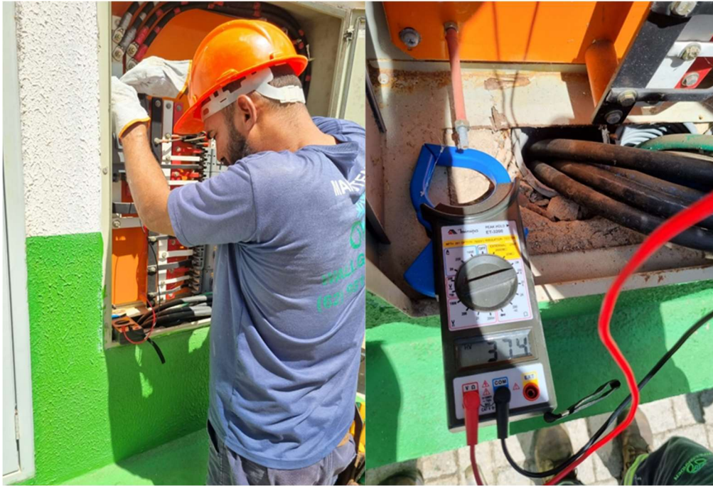
Inspeção de quadros elétricos
