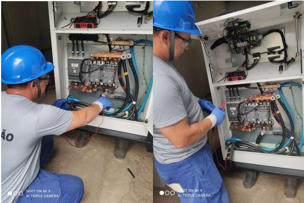
MANUTENÇÃO PREVENTIVA DO GRUPO GERADOR 01
