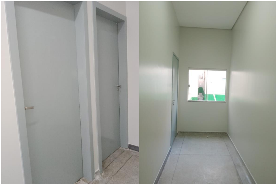
Clínica Cirúrgica: adequação de estrutura física para instalação de novo posto de enfermagem (conforme orientações da SUVISA)
