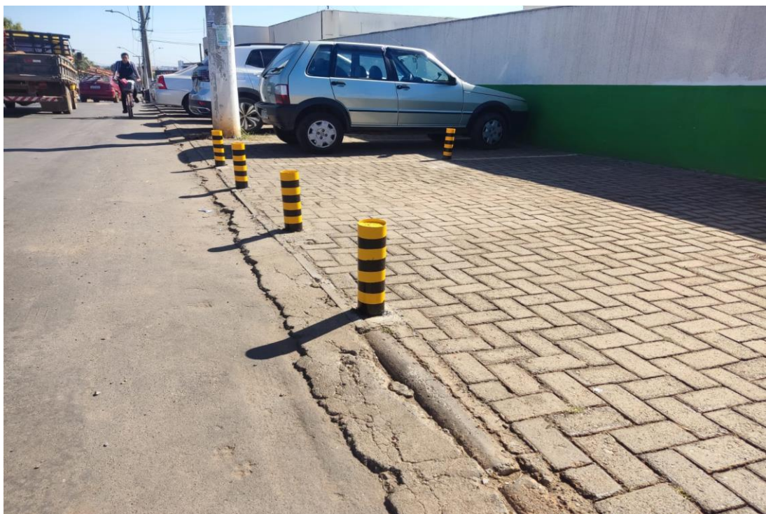
Estacionamento Externo: bloqueio de vagas próximo ao portão de acesso de cargas/descargas
