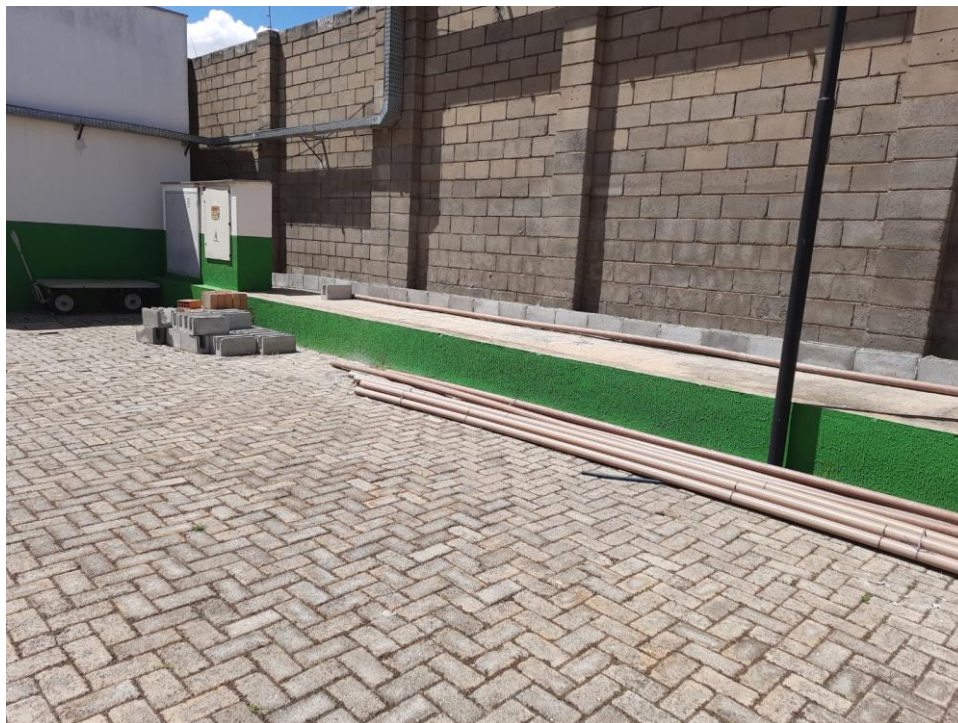
Área Externa: execução de nova infraestrutura hidráulica para abastecimento dos reservatórios de água
