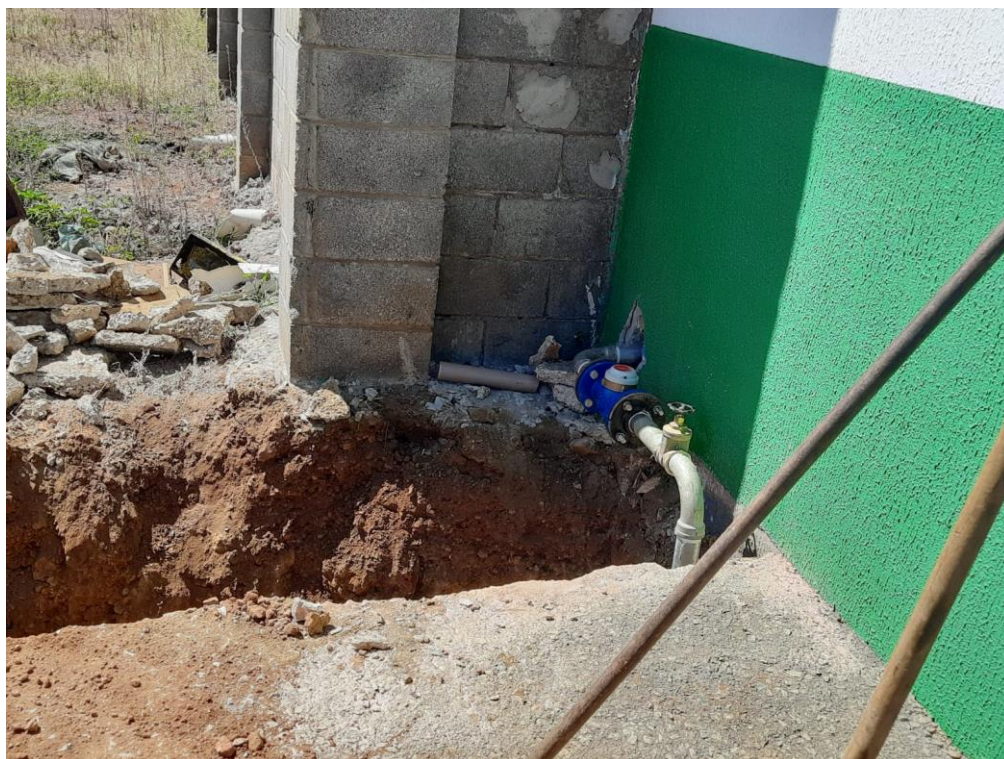
Área Externa: execução de nova infraestrutura hidráulica para abastecimento dos reservatórios de água
