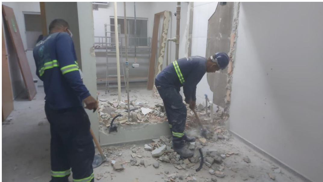
Clínica Cirúrgica: adequação de estrutura física para instalação de novo posto de enfermagem (conforme orientações da SUVISA)
