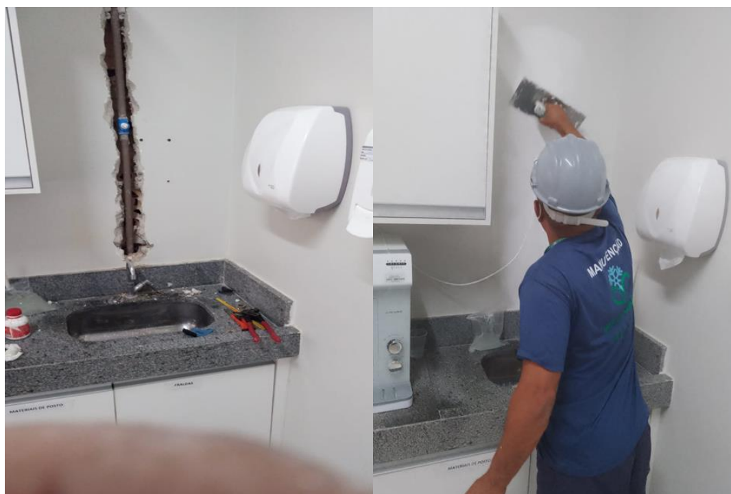
Instalação de purificador de água no posto de enfermagem da clínica cirúrgica
