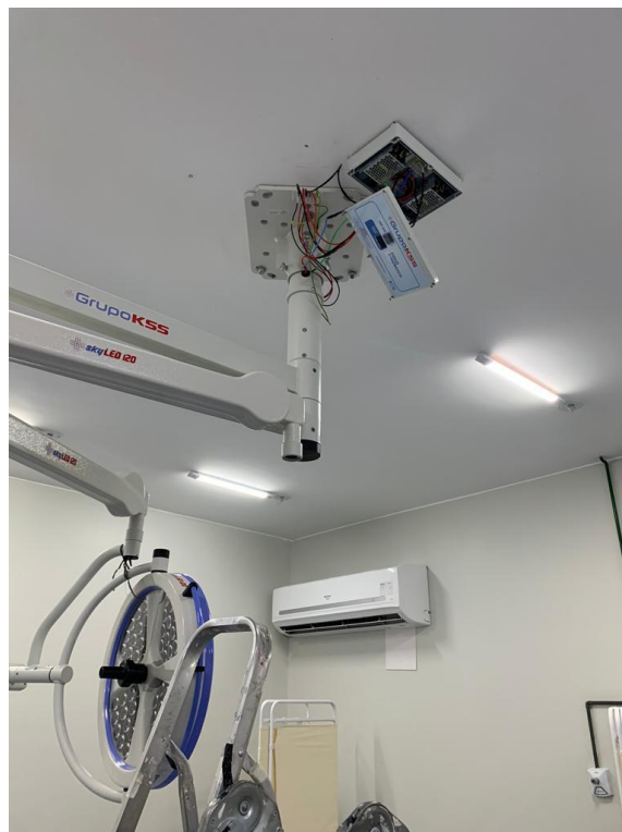
Imagem 1 - Instalação Foco Cirúrgico de teto
