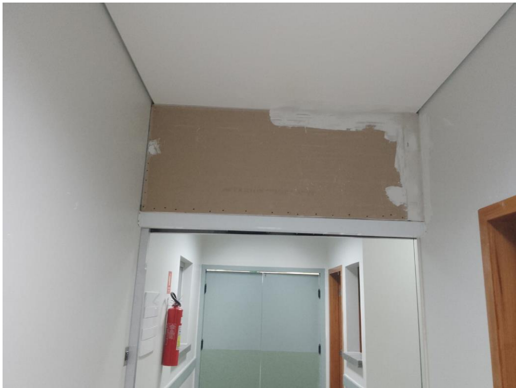
Centro Cirúrgico: fechamento de vão com estrutura em drywall acima da porta de vidro automática
