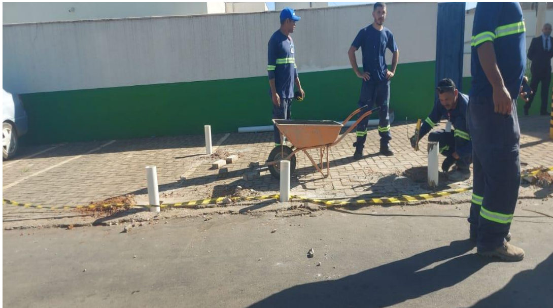
Estacionamento Externo: bloqueio de vagas próximo ao portão de acesso de cargas/descargas
