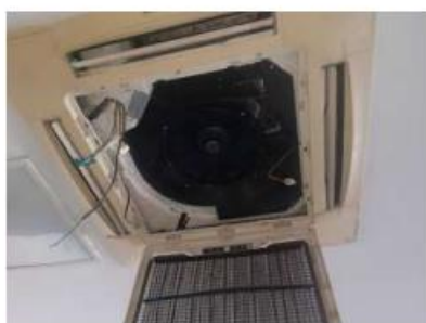
máquina 01 = recepção emergência sem a placa e sem a bomba de dreno
