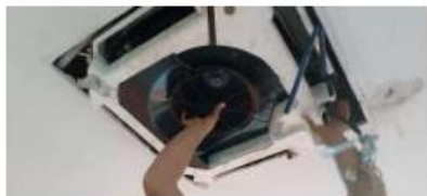
máquina 03= refeitório está sem placa s/bomba de dreno s/boia de nível da bandeja
