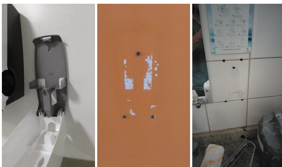
Situacional de dispenser retirados e quebrados em alguns setores
