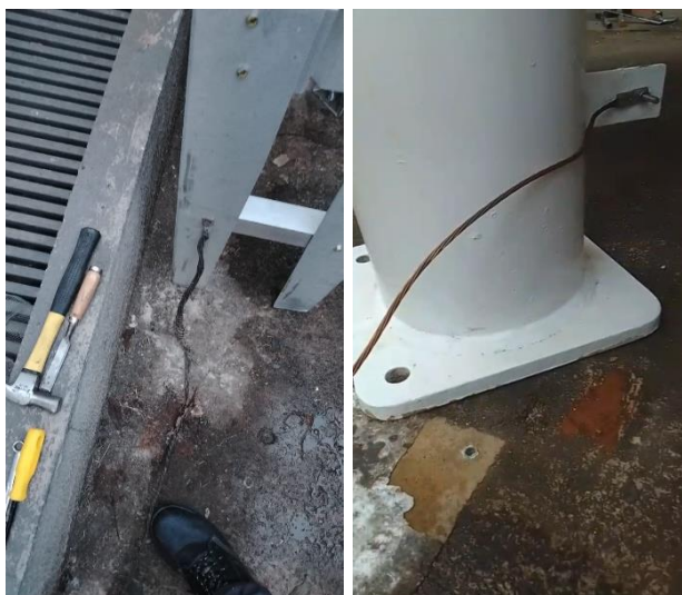
Aterramento da central de vaporização e tanque de oxigênio.
