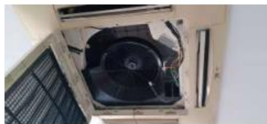
máquina 02 emergência sem a placa e sem a bomba de dreno
