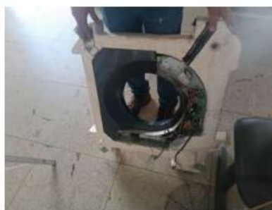
placa com defeito cassete 01 recepção emergência
