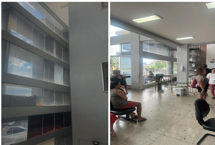
Películas antigas deteriorada e vidro quebrado
