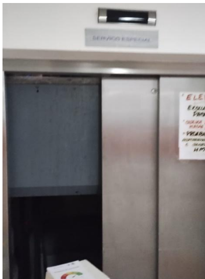
Elevador parado sem funcionamento
