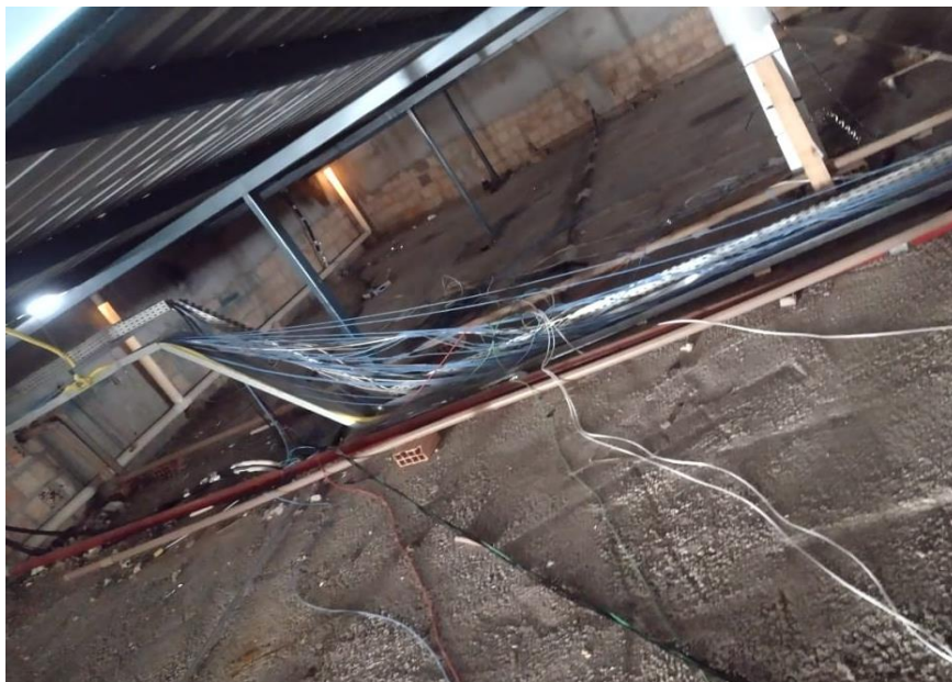
Imagem 01: Instalações elétricas existentes (sótão cozinha)
